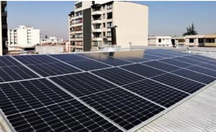
Entrada en funcionamiento de Paneles Solares Casa Grajales.
